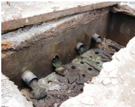
Dans une fosse septique, les boues peuvent encrasser le filtre et colmater tout le drainage
