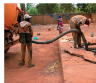
Collecte et évacuation
