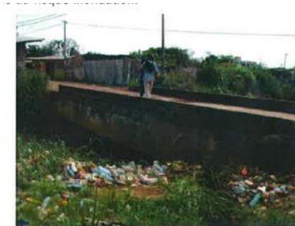
Figure 10 : Pont présentant une restriction très forte à l'écoulement (section ouverte très faible)
