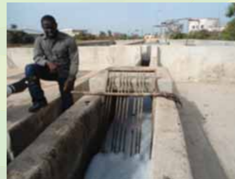
Dégrilleur endommagé et rouillé
