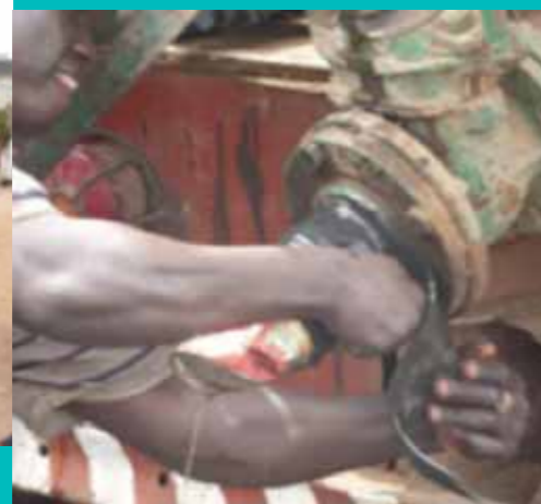
Vanne de vidange défectueuse bricolée à l'aide de morceaux de chambre à air
