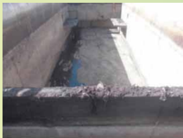
Etat des bassins après curage par l'opérateur privé
