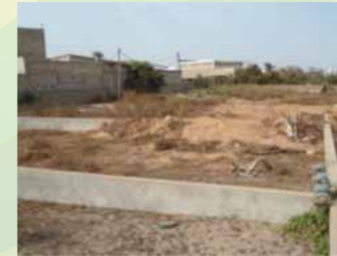
Lits de séchage délabrés et vannes défectueuses
