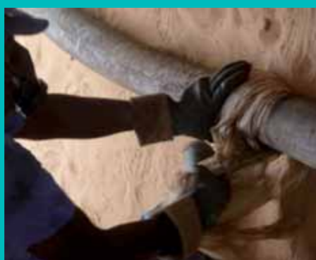
Vanne de raccordement défectueuse
