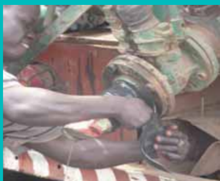
Vanne de vidange défectueuse
