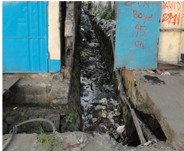
ETAT DES DRAINS ENTRE DEUX MAISONS
