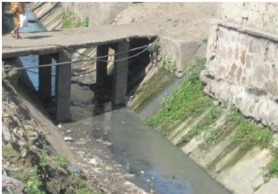
PAUK/PARAU - PONT DODOMA AVANT REHABILITATION
