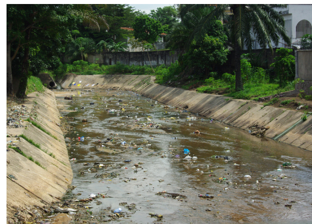
DÉCHARGE DES DÉCHETS DANS UNE RIVIÈRE
