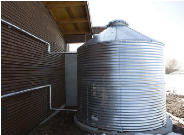
EXEMPLE DE RESERVOIR INDIVIDUEL
