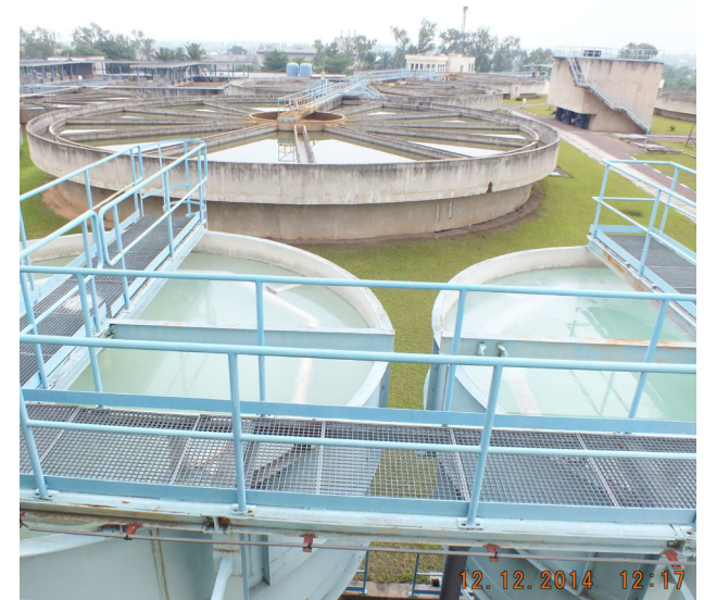
DECANTEUR DE L'USINE DE NDJILI
