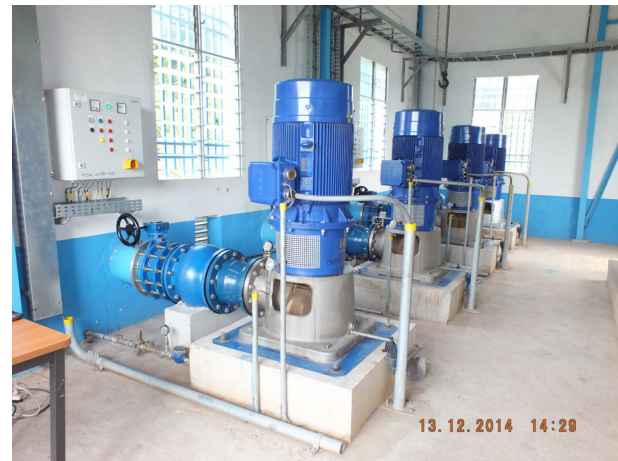
VUE DE L'USINE DE CAPTAGE DE LUKAYA
