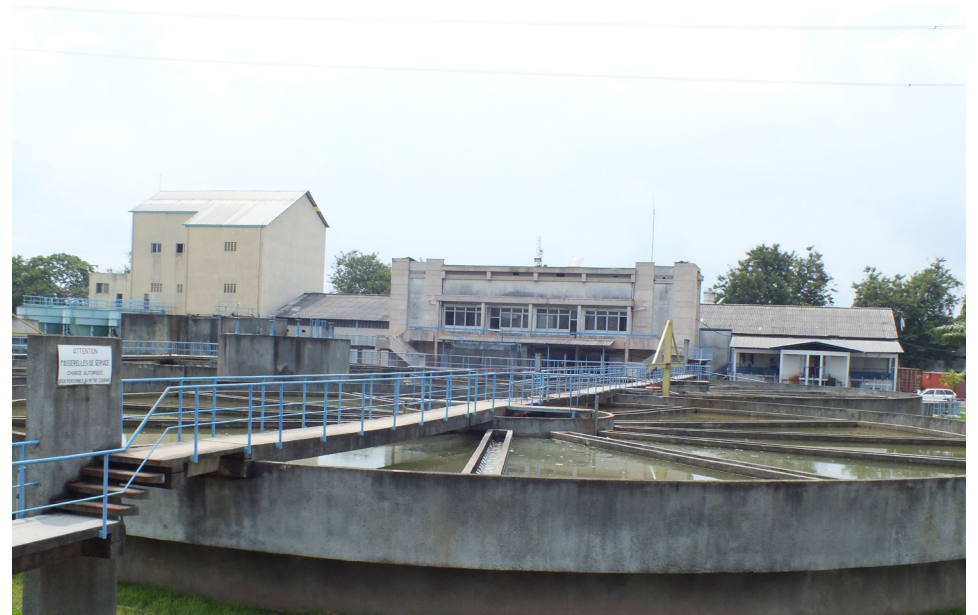
VUE DU DÉCANTEUR DE L'USINE N'DJILI
