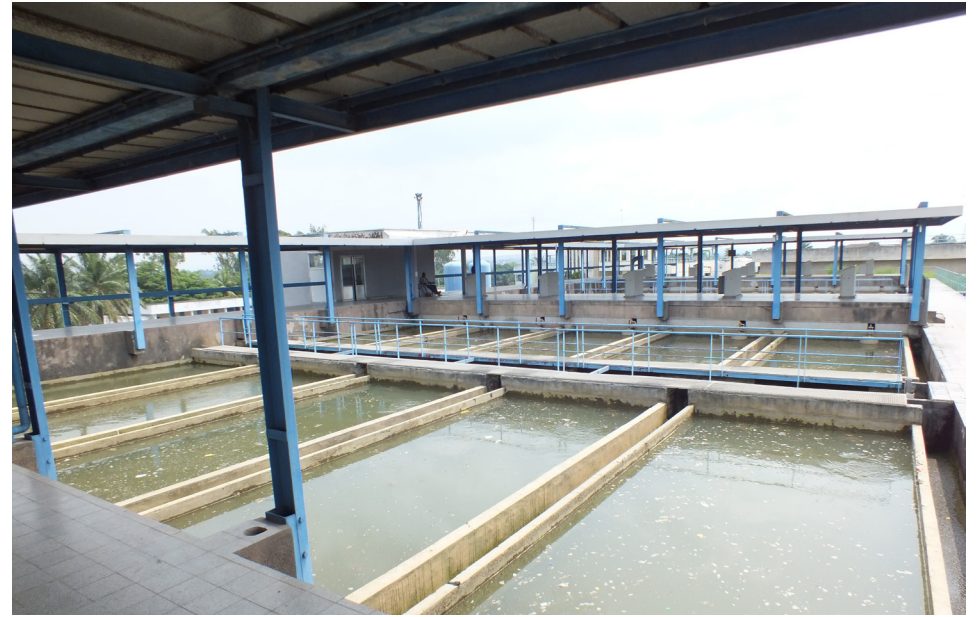
PHASE I, FILTRE DE L'USINE N'DJILI
