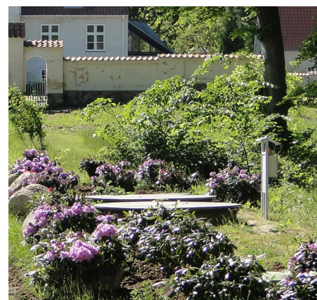
Mars 3000 installé dans une école
