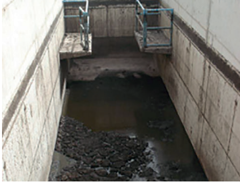
Figure 6.6 : Bassin de décantation et d'épaississement de Rufisque, Dakar, Sénégal, montrant la couche d'écume (photo : Sandec).
