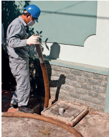
Figure 4.3 : Exemple de regard de visite d'une fosse septique conçue pour permettre un accès rapide, Vung Tau Province, Vietnam (photo : Linda Strande).
