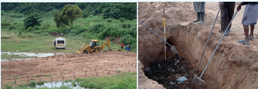
Figure 5.3 : Site expérimental d'enfouissement en tranchées profondes d'Umlazi. À droite : enfouissement des boues de latrines dans des tranchées d'un mètre de profondeur. À gauche : vue générale des plantations d'arbres sur les tranchées remplies. Les puits d'eau potable étaient répertoriés et les niveaux de nutriments, de matières organiques et d'agents pathogènes surveillés (photos : Jay Bhagwan, Water Research Council, Afrique du Sud).
