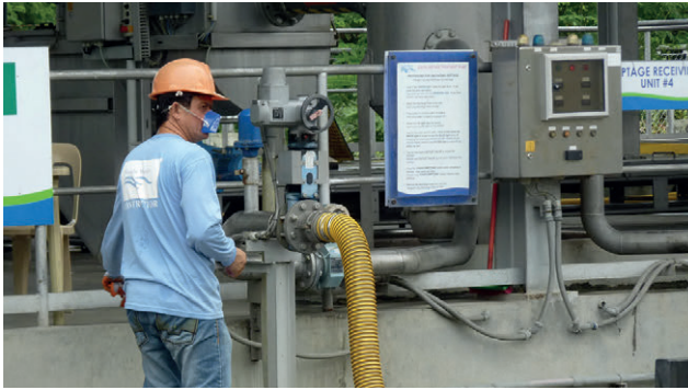
Figure 4.16 : Unité de dépotage mécanisée au niveau de la station d'épuration South Septage de la société Manila Water, à Manille, aux Philippines (photo : WSUP, Sam Parker).
