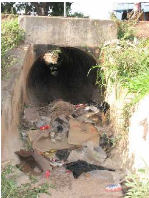
Photo 14 : Canal d'évacuation des eaux pluviales longeant la RN4 remplis avec des déchets ménagers.
