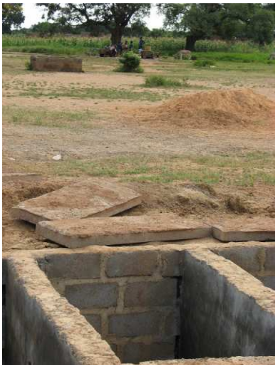
Photo 22 : Les fosses de latrines construites simplement en terre ou avec des perforations des murs causent des contaminations en azote de la nappe phréatique.
