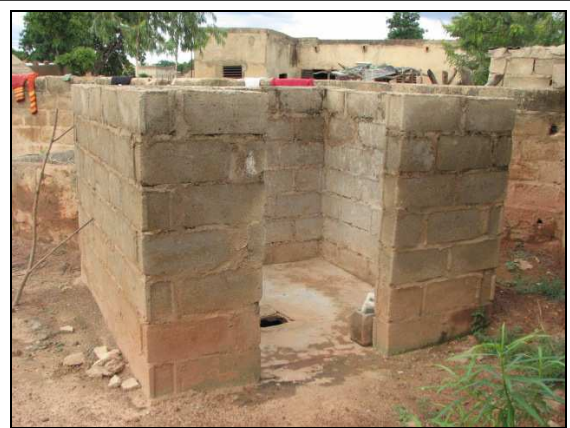
Photo 26 : Latrine traditionnelle à l'air libre avec une dalle, qui donne aucun autre accès pour vidanger que par l'agrandissement du trou existant.
