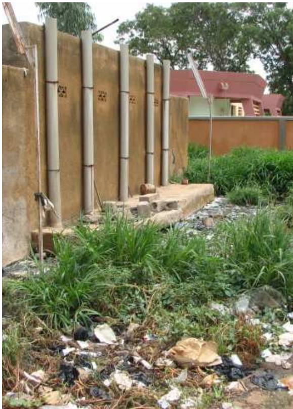
Photo 44 : Site de dépotage intermédiaire du Centre Hospitalier Régional (CHR) derrière le bloc de latrines. L'hôpital réduit de telle manière la fréquence d'appeler le camion aspiratoz.
