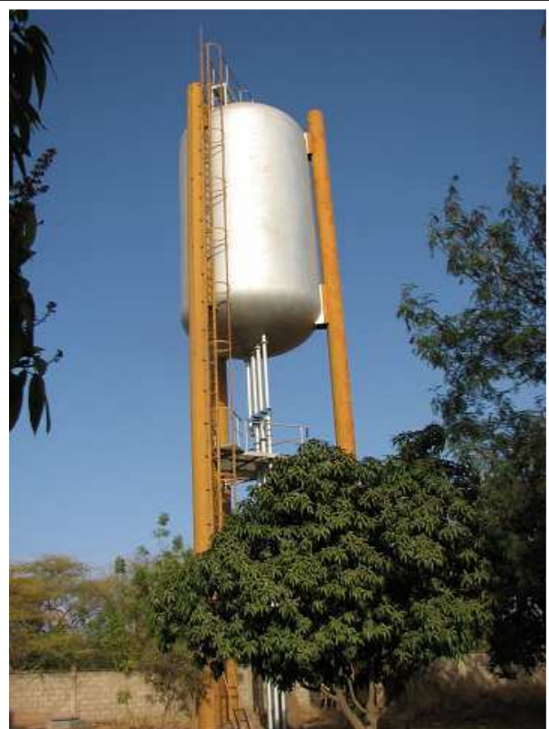
Photo 9 : Château d'eau de l'ONEA dans le secteur 2 de Fada N'Gourma.
