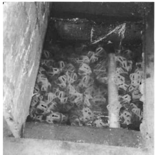
Fig. 21: Billes flottantes en plastique comme matériau filtrant. Lorsque le film bactérien devient trop lourd, les billes se retournent et versent leur chargement. Ce matériau filtrant a été utilisé avec succès pour des eaux usées provenant de la fabrication du "tofu" par HRIEE dans la province de Zhejiang en Chine, [photo: Sasse]
