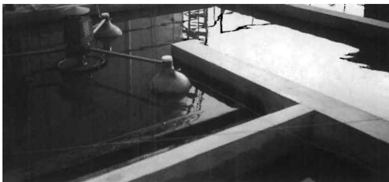
Fig- 1: Un parmi les trop nombreux aérateurs qui n'aèrent rien du tout [photo: Sasse]
