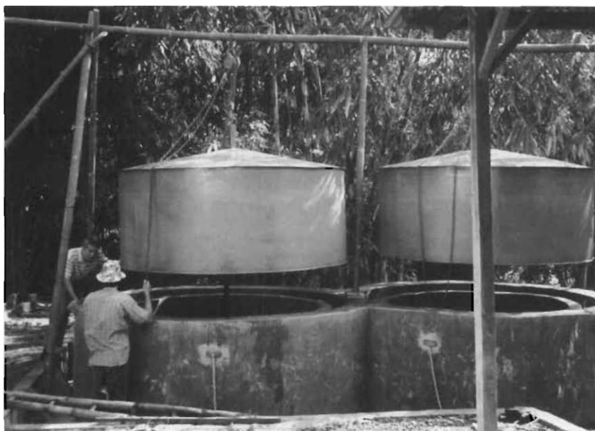
Fig. 57: Système à caisson flottant. Les caissons ont ici été enlevés pour être repeints, ce qui donne une vue du mur double assurant l'étanchéité par l'eau. Construit par LPTP et BORDA pour un abattoir à Java (Indonésie) [photo: Sasse]
