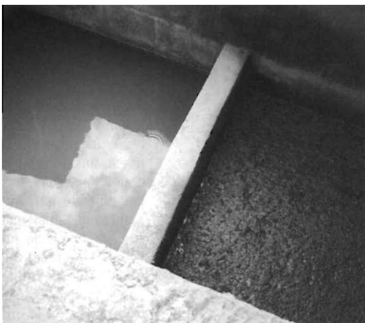
Fig. p: Cloison retenant les flottants. L'alimentation se fait par la droite, l'eau s'écoule sous la paroi dans le compartiment situé à gauche.[photo: Sasse]
