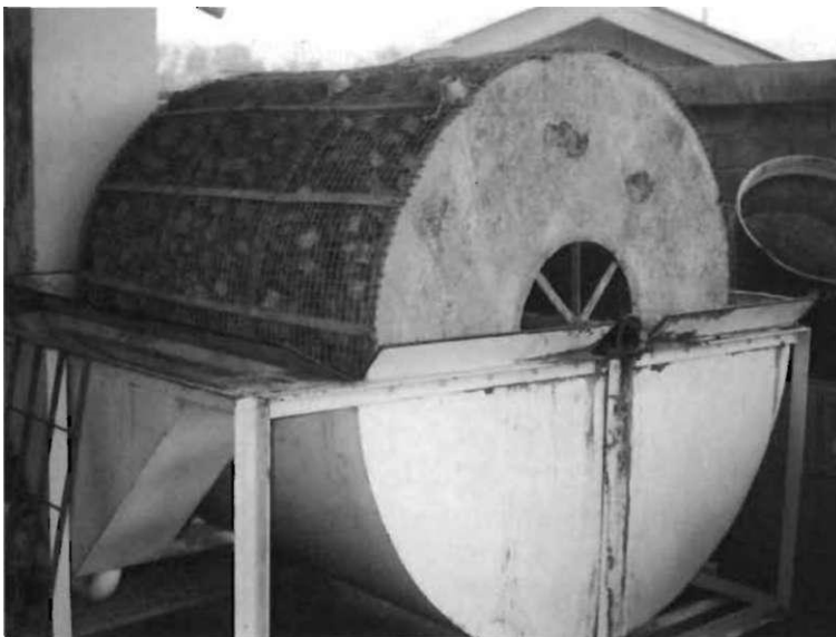
Fig. 52: Disques biologiques dans un abattoir de Jakarta (Indonésie). Le dispositif était temporairement hors d'usage lorsque la photo a été prise [photo: Sasse]
