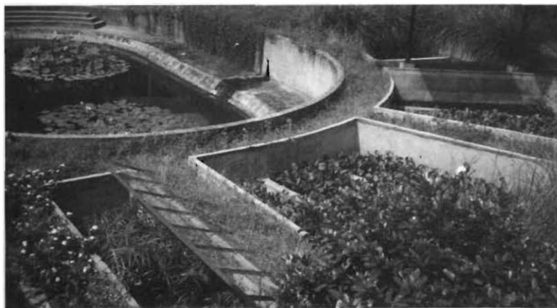
Fig. 48: Bassins de traitement des eaux usées avec plantes aquatiques à Auroville (Inde). La station est placée juste à côté de maisons d'habitation. Les lézards qui vivent dans les jacinthes d'eau se chargent des moustiques. Le premier bassin de décantation est scellé contre les mauvaises odeurs par une épaisse couche d'écume, sur laquelle se développent des papyrus (cf. Fig. 46) [photo: Sasse]
