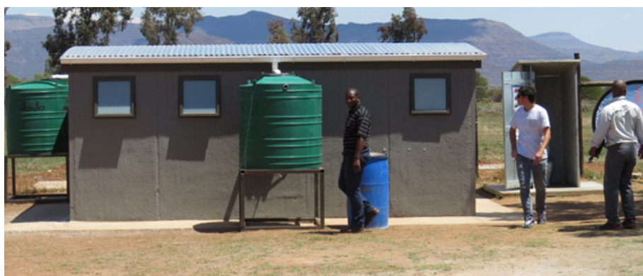
The installed pour flush toilets.
