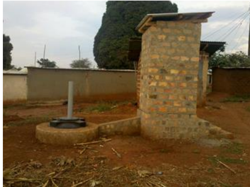
Pour flush toilets
