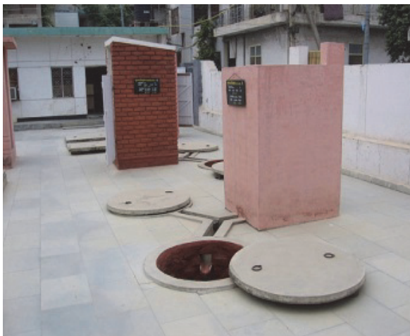
Pour flush system in Asia.
