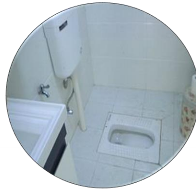
Cistern flush toilet
