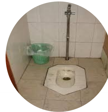
Pour flush toilet
