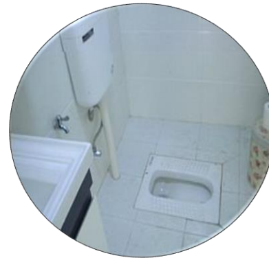
Cistern flush toilet
