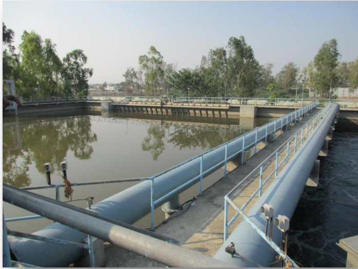
Centralized treatment plant மையப்படுத்தப்பட்ட கழிவு சுத்திகரிப்பு அமைப்பு
