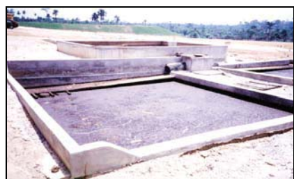
Photo 2: Sludge drying beds (Kumasi)
